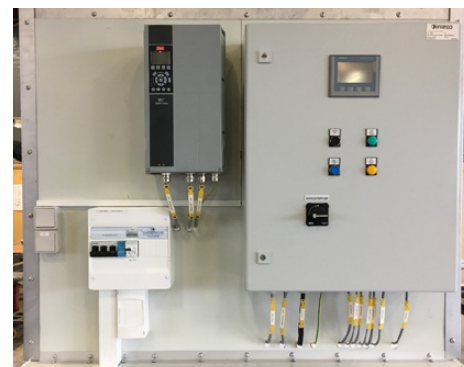
Figur 5: Eksempel på standardstation fra el-siden
