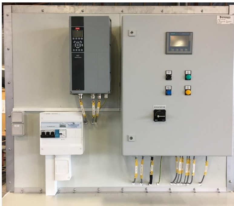
Figur 5: Eksempel på standardstation set fra el-siden
