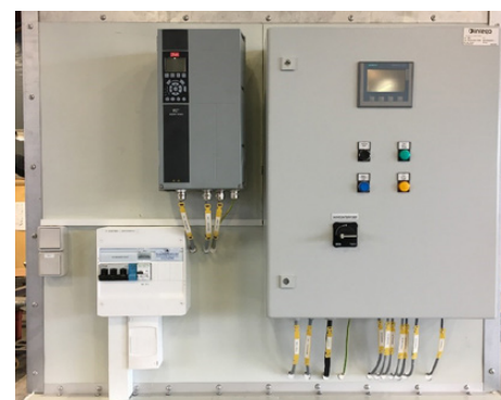
Figur 5: Eksempel på standardstation fra el-siden
