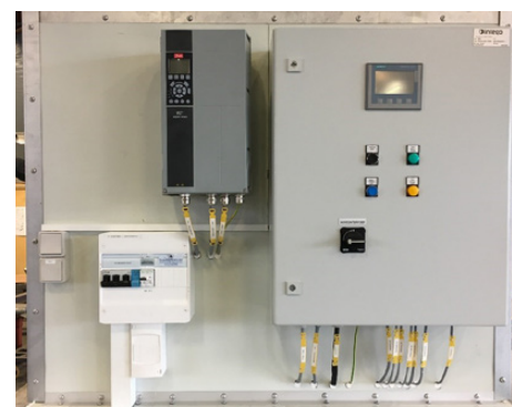
Figur 5: Eksempel på standardstation fra el-siden
