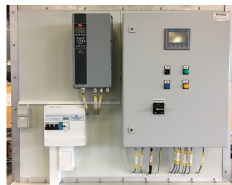
Figur 5: Eksempel på standardstation fra el-siden
