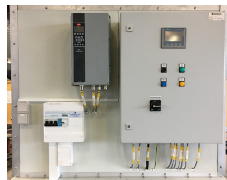
Figur 5: Eksempel på standardstation fra el-siden
